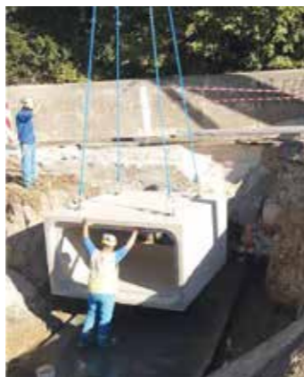
Mise en place d'un cadre pour élargir le pont du canal du Moulin sur D93
