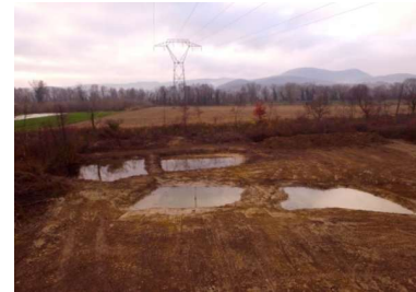
Aménagement de mares sous une ligne à haute tension, Alex
